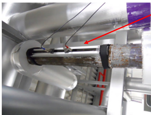
外部取付の 超音波流量計
