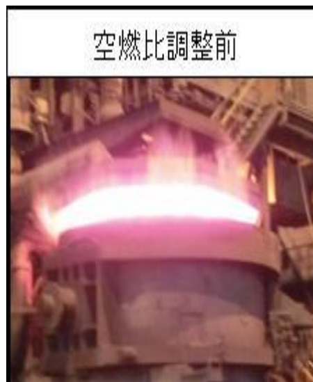
過剰なLNGが外部で燃焼
