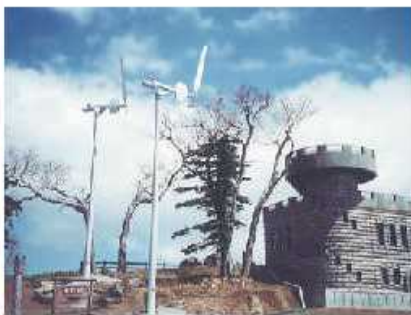
風力発電設備
