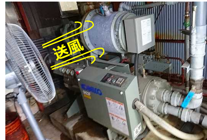
写真. 冷凍機 (凍結庫)
