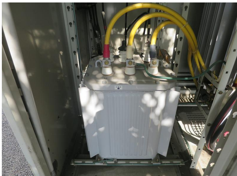
既存油入り変圧器
