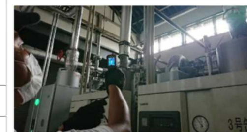
脱炭素診断の現地調査 (エネルギー計測)
